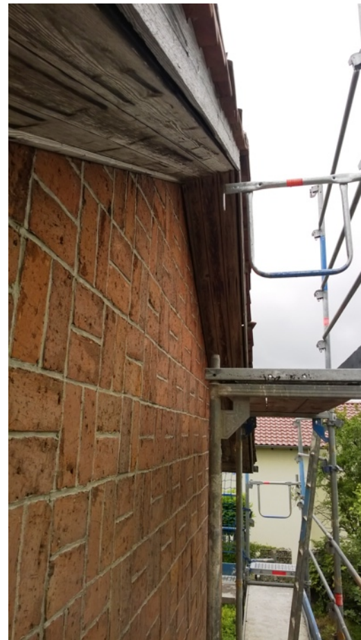
Der Prüfverband präsentiert sich nach rund 65 Jahren in erstaunlich gutem Zustand
